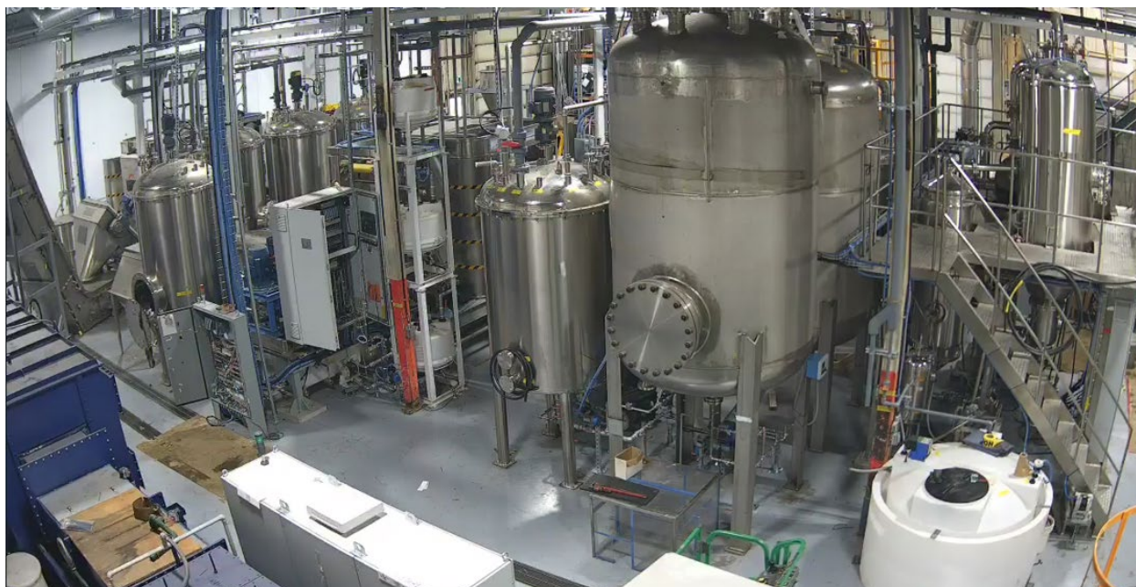
Figure 1 : Vue de l'assemblage de l'usine de démonstration de recyclage des terres rares
