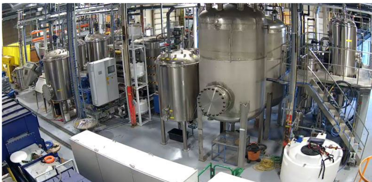
Figure 1: Vue de l'assemblage de l'usine de démonstration de recyclage des terres rares
